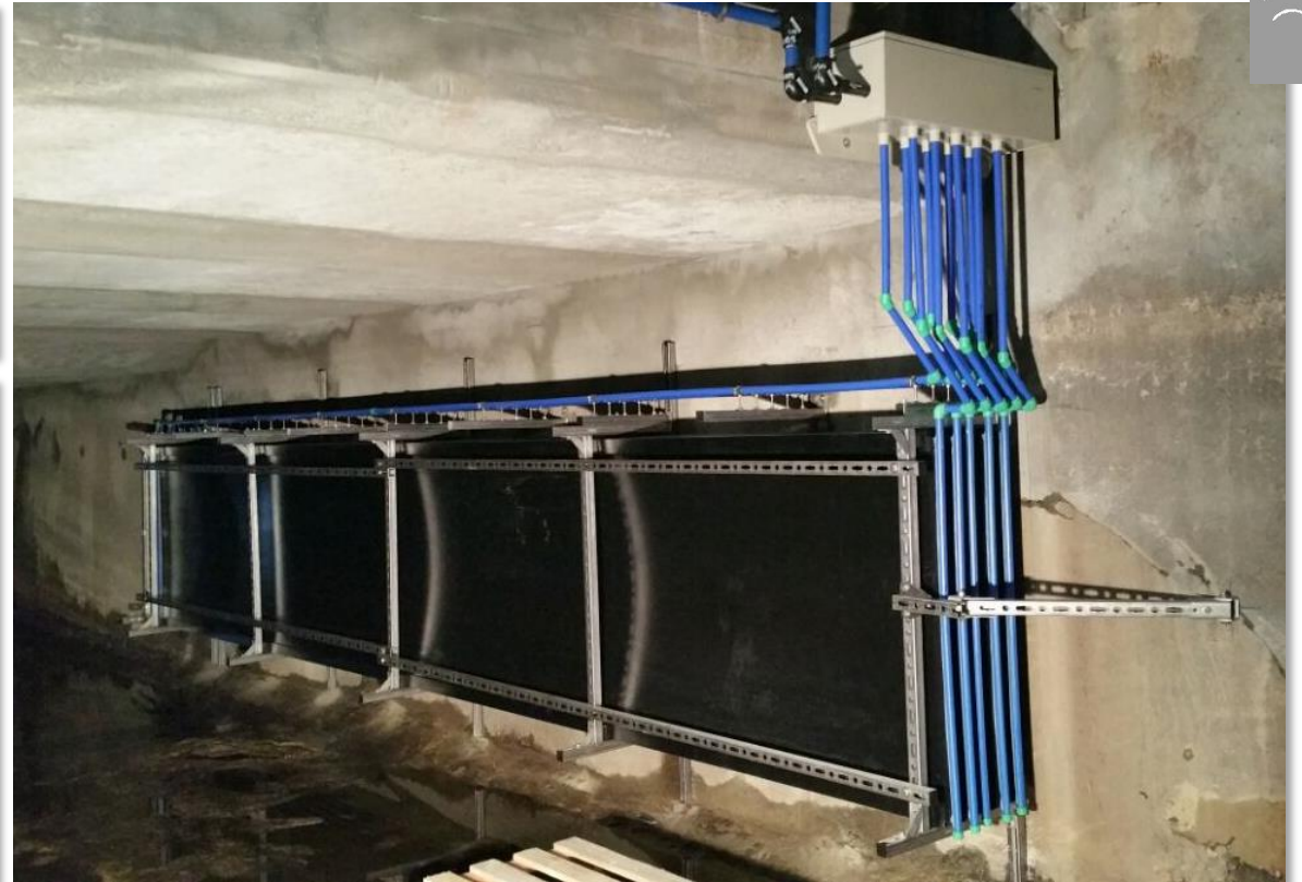
Installation im Kanal vor einer Elektroturbine
